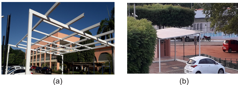
Figura 1 - (a) Detalhes da estrutura metálica e (b) Painéis fotovoltaicos instalados
