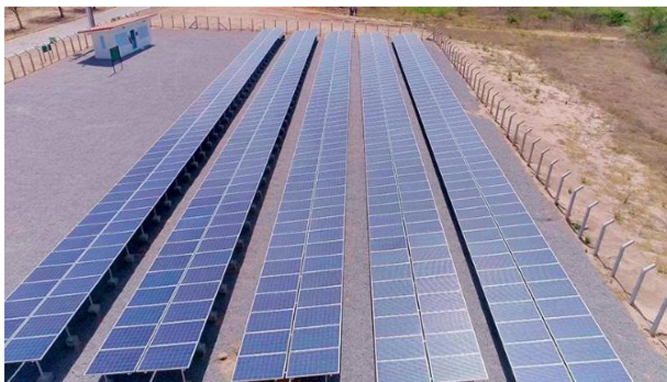
Figura 5 – Layout da minigeração fotovoltaica da UFRS – Campus Mossoró
