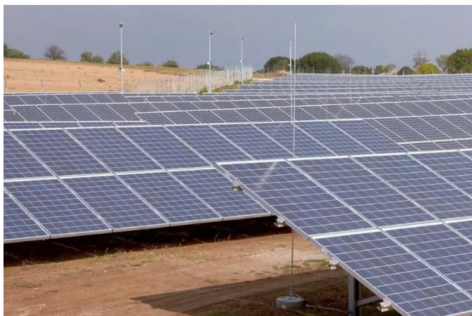
Figura 4 – Instalações reais de um SPDA em um sistema fotovoltaico 1
