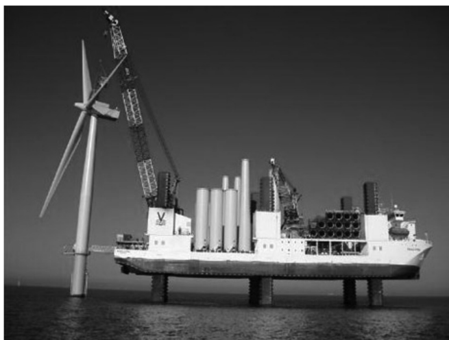
Figura 15 – Instalação Real de uma Grande Unidade Aerogeradora Offshore. Fonte: Google Imagens (2010)
