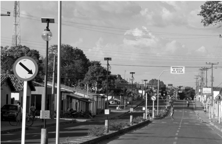
Figura 3 – Sistema fotovoltaico de iluminação, São Gonçalo do Piauí (Foto: Albermerc Moraes, fev. 2012)
