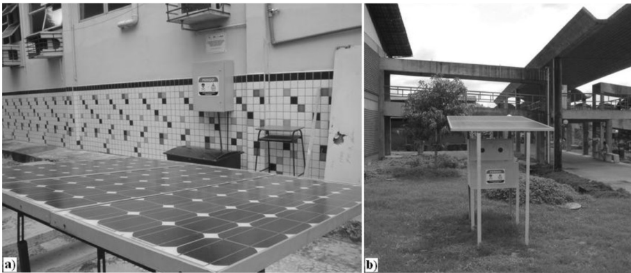
Figura 5 – Sistemas fotovoltaicos instalados: a) IFPI (195 Wp) e b) UFPI (504 Wp) (Foto: Albemerc M. Moraes, fev. 2008)
