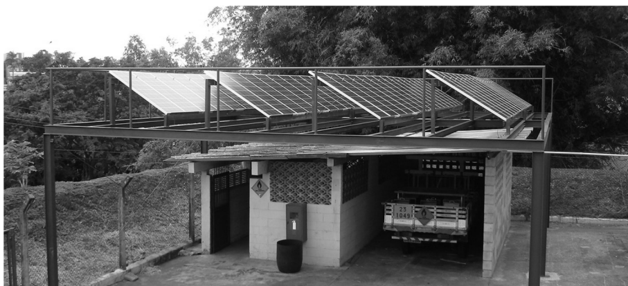
Figura 5 - Instalação fotovoltaica do Projeto PD-28
