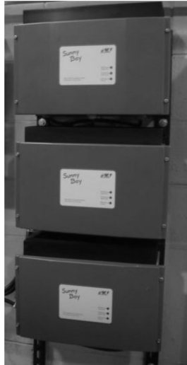
Figura 6 - Inversores Sunny Boy (SMA) instalados no PD-28
