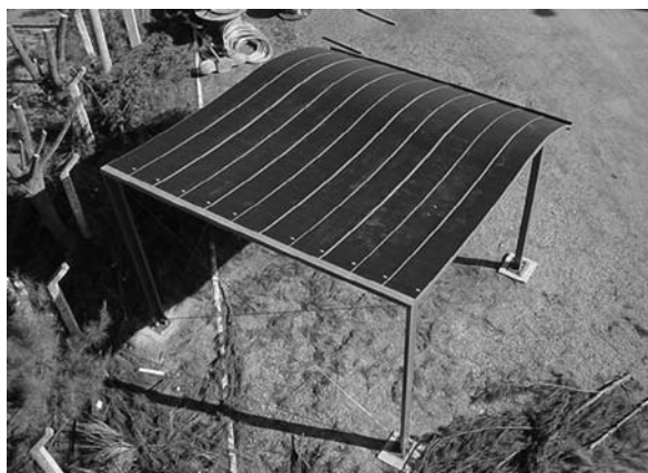
Figura 4: Vista superior do sistema de 1,4kWp instalado em Tubarão (LABSOLAR).
