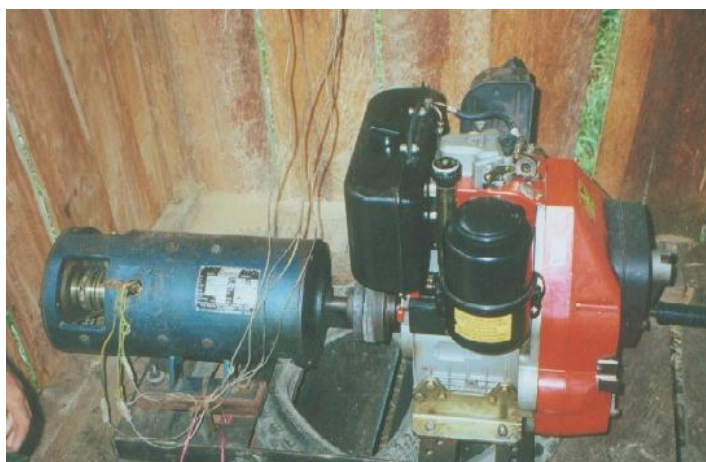
Figura 6. Moto-gerador Diesel da comunidade de Vera Cruz.
